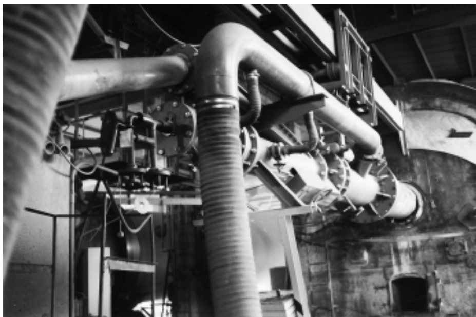
Obrázek: Čelní strana cementářské rotační pece s kombinovaným hořákem a potrubím pro vstu přidavného tuhého paliva
