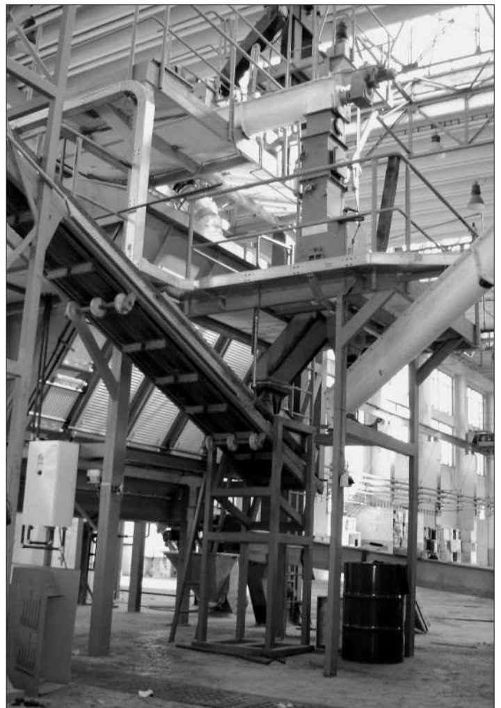
Obrázek 3: Část drtícího a dopravního zařízení druhého stupně zpracování
