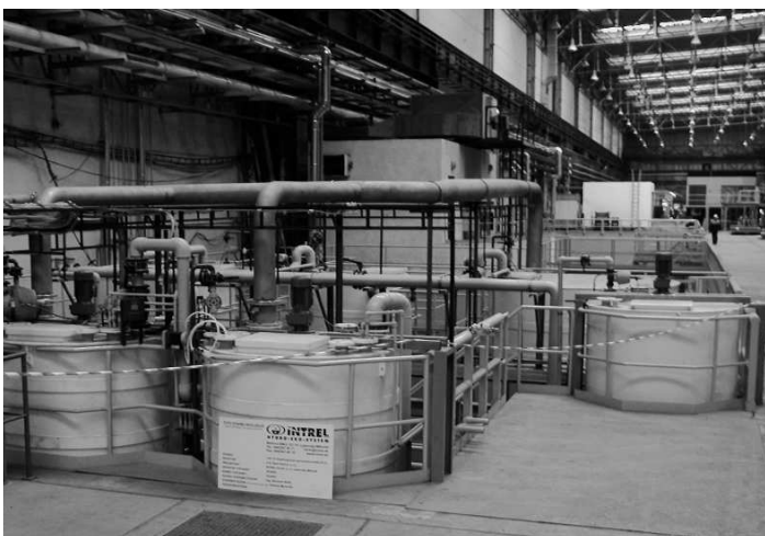
Neutralizační stanice zahrnující proces oxidace a redukce Cr 6+ a fenolů
