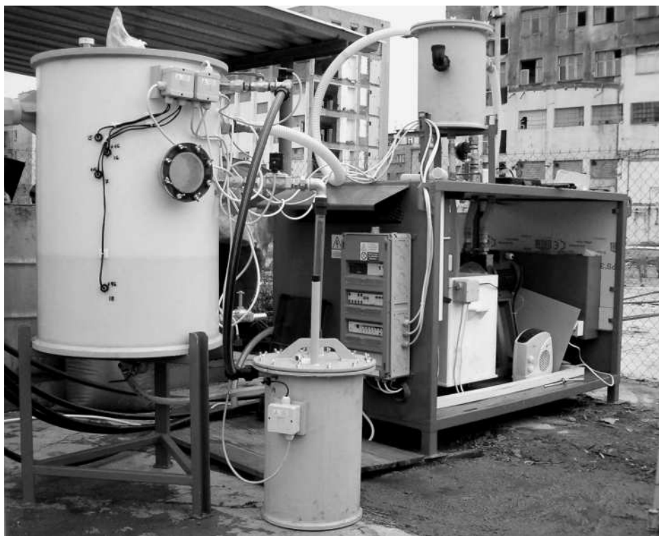
Obrázek 1: Celkový pohled na technologické zařízení pro bioslurping s automatizovaným provozem
