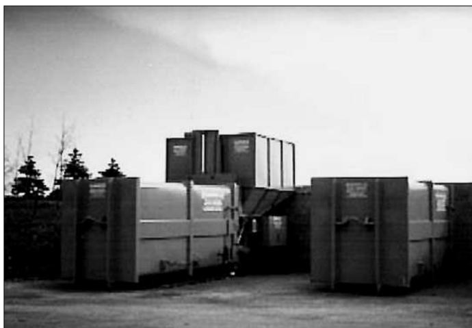
Obrázek 1: Malá, mechanická překládací stanice
