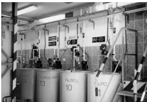
Predčistiaca stanica výluhových vôd zo skládky tuhého komunálneho odpadu
