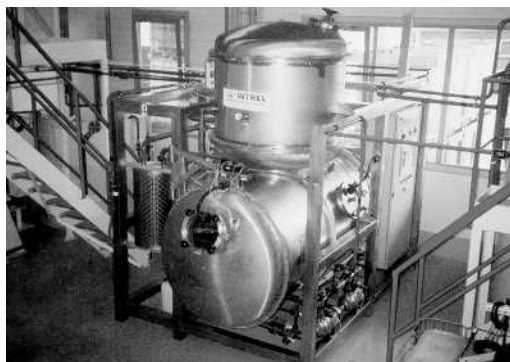
Deemulgačná stanica na zneškodňovanie olejových emulzií z výroby prevodoviek
