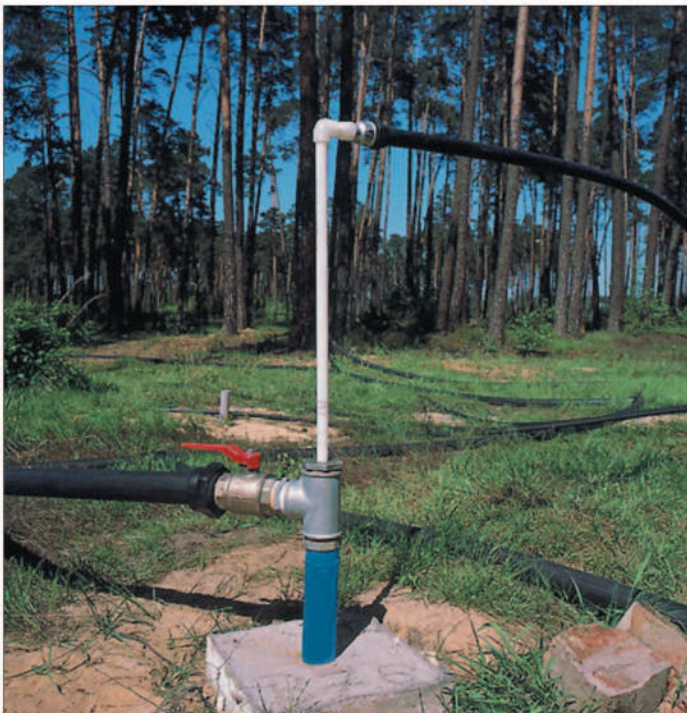
Obrázek 1: Lokalita Hradčany – kombinovaný ventingový vrt s podtlakovým odsáváním fáze ropných uhlovodíků z hladiny podzemní vody
