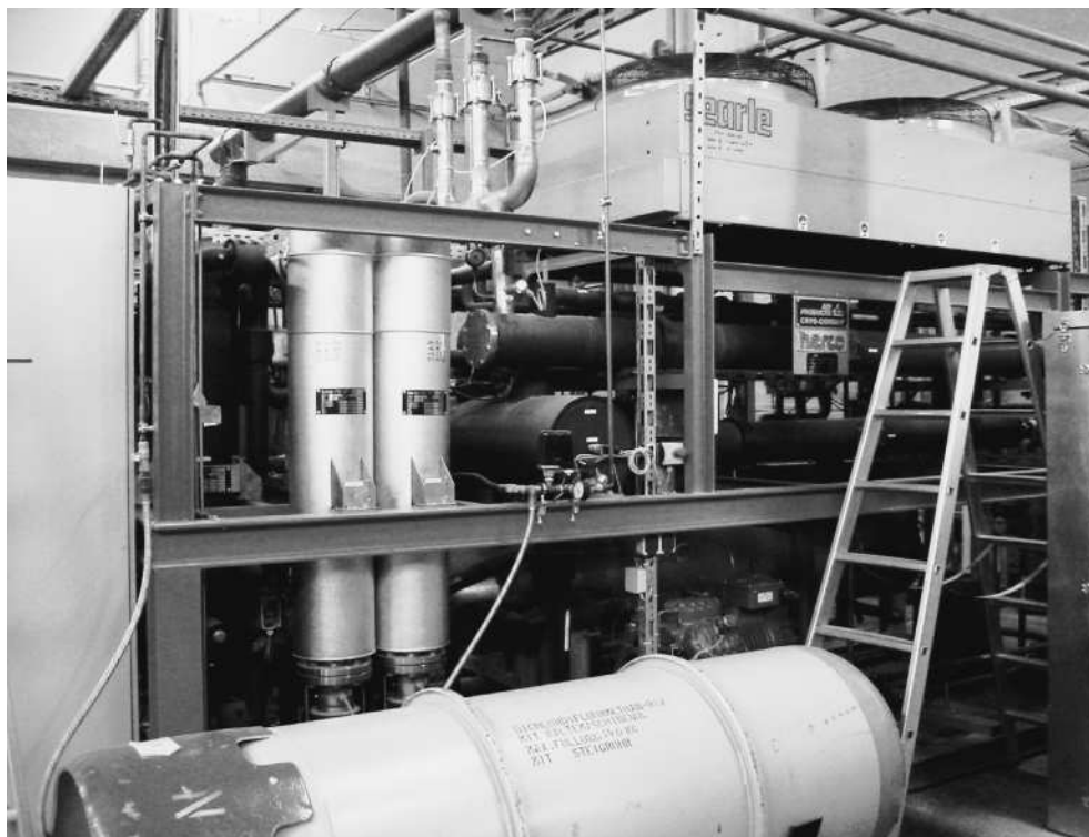
Obrázek: Recyklační závod na zpracování chladicí techniky
