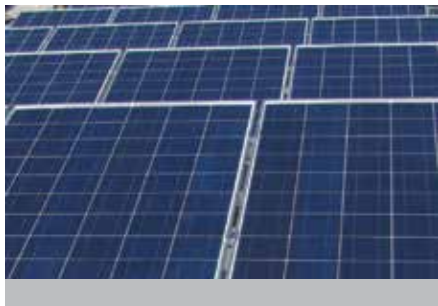
Obrázek 4: Detailní záběr na FV panel
