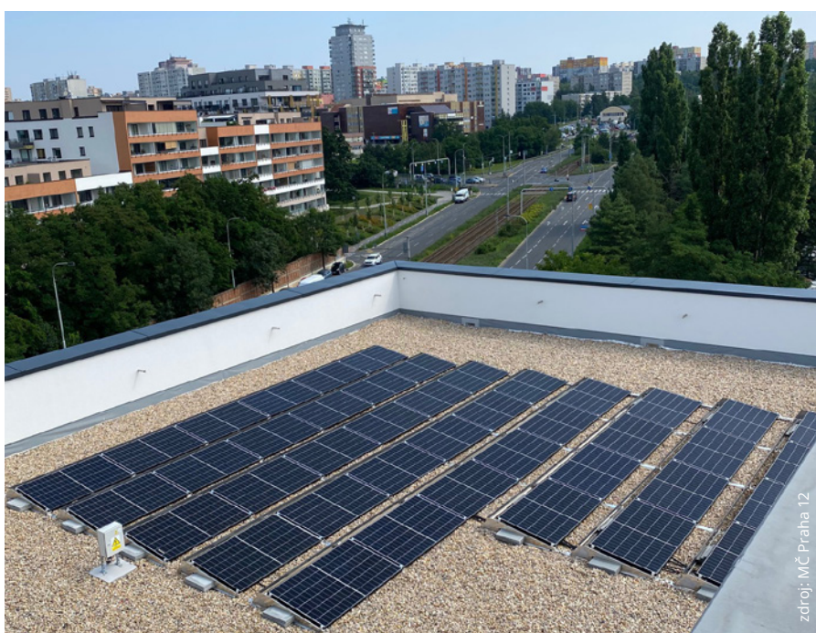
Fotovoltaická elektrárna na střeše nové radnice Prahy 12
