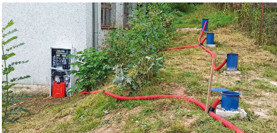
Obrázek 3: Dokončená instalace sanační a monitorovací technologie v lokalitě (instalační sloupek je otevřený pouze pro fotodokumentaci, jinak je uzavřený)
